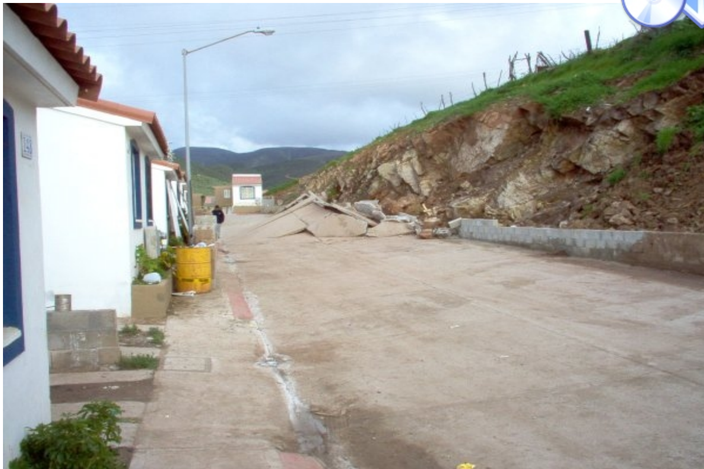
Figura 1. Deslizamiento de tierra ocurrido en Ensenada, México, en un cerro de roca intemperizada, colindante con un fraccionamiento de reciente creación.
